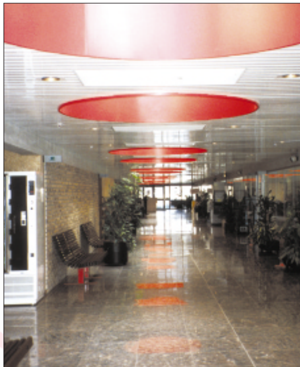
Кассеты НР обеспечивают мягкий обогрев без движения воздуха. Прямоугольные белые кассеты хорошо вписались в яркое архитектурное решение потолка.
