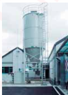
Известковый бункер. Дозировка жженой извести в насос для дополнительной обработки производится при помощи системы управления сеерех SLCO.
