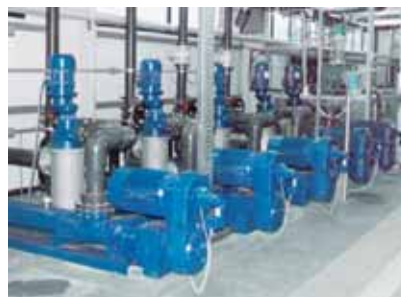
Насосы seepex BN 130-6L с предвключенными мацераторами seepex U 110. Продукт: избыточный шлам.
