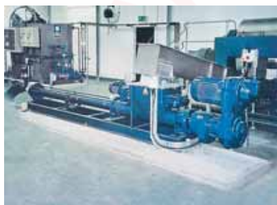
Насосы seerex BTI 17-48 . Продукт: обезвоженный шлам из центрифуги с примерно 25% сухого остатка.
